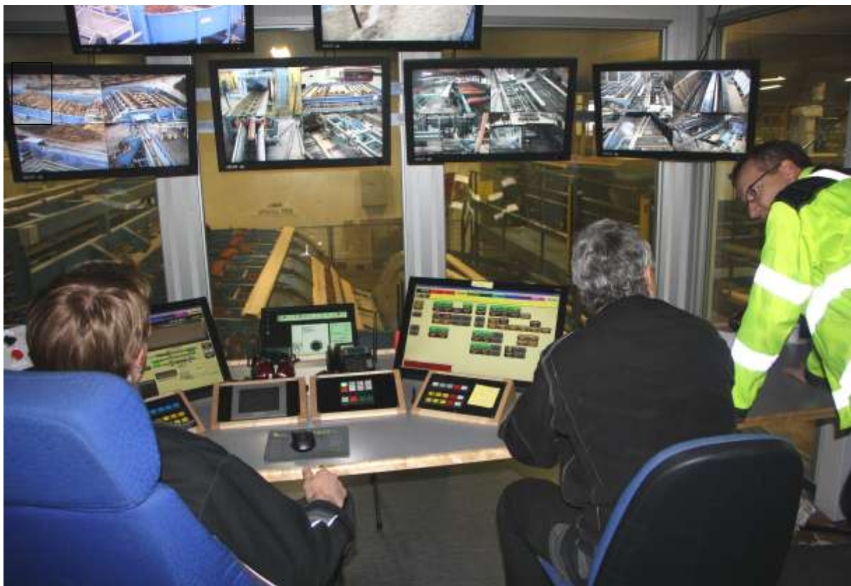
Kontrollrommet hos Mjøsbuket. Foto: Berit Sanness
